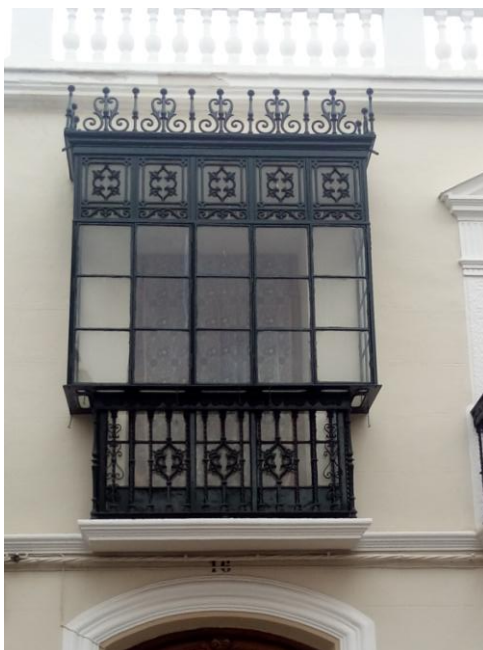
Figura 6. Balcón de estilo neoclásico. Calle Eliseo Ramírez n 16. Principios del siglo XX.
