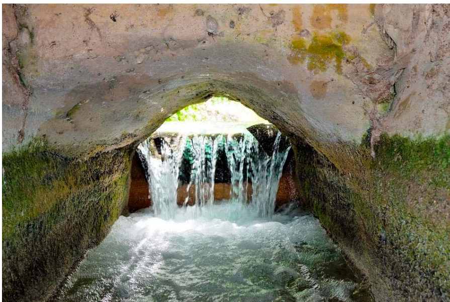
Figura 2: Una de las compuertas de la Compuerta Real de Ruidera. En la actualidad sigue recibiendo y conteniendo las aguas de la laguna del Rey. Fuente: Foto del autor.
