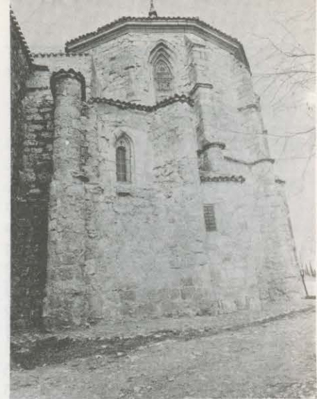
VISTA EXTERIOR DEL ABSIDE CUYO DERRUMBAMIENTO HA COMENZADO
