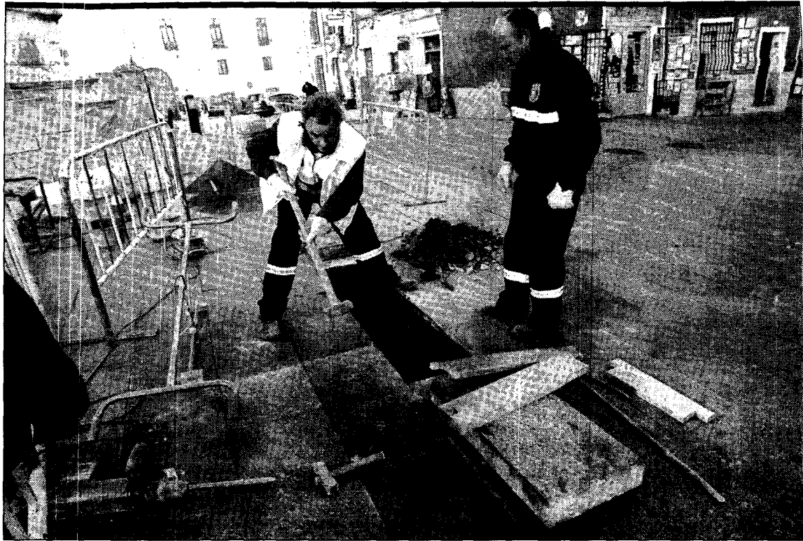
Arreglos en el pavimento de la Plaza Mayor. Operarios del servicio de obras del Ayuntamiento de Cuenca trabajaban ayer reponiendo varios bloques del pavimento de la Plaza Mayor que se encontraban en mal estado. Una reforma necesaria para evitar problemas pero que puede resultar efímera ya que el Ayuntamiento ha anunciado un concurso de ideas para remodelar este importante espacio. / FOTO: R. MARTÍNEZ
