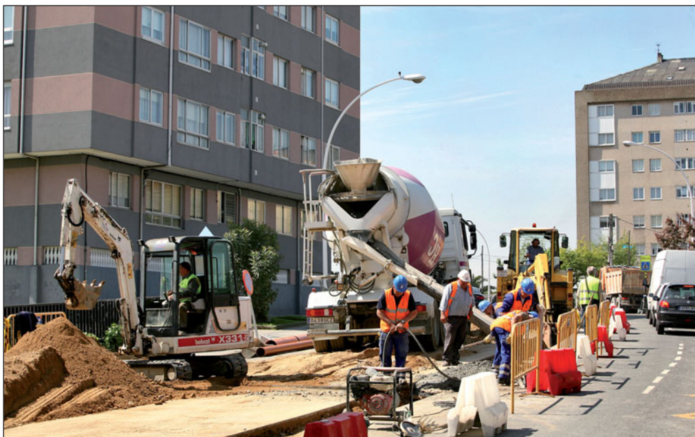
La partida presupuestaria que cuenta con una mayor dotación en Albacete es la correspondiente a infraestructuras productivas, con una inversión cercana a los 150 millones de euros. En la imagen, obras en calles.
