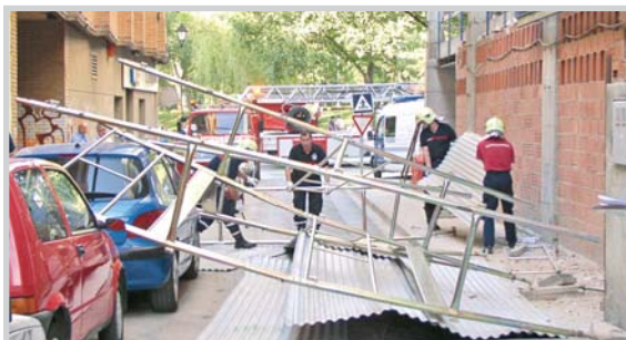
Un andamio cae al suelo por el viento.
