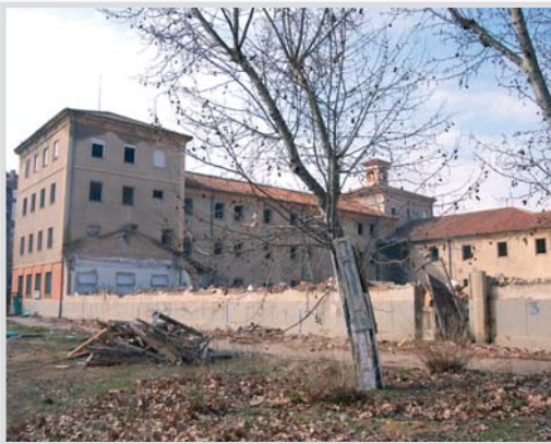
Parte trasera derruida del Gíner de los Ríos.
