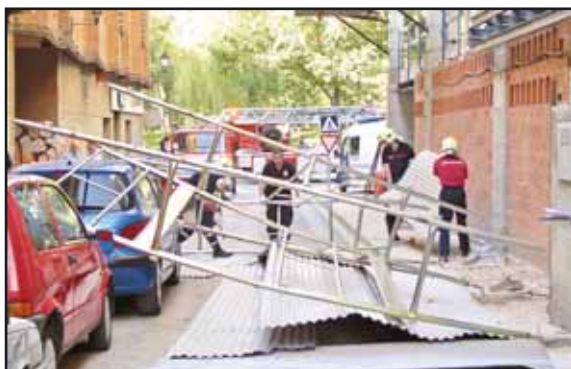
Un andamio se cae debido a su mala sujeción.
