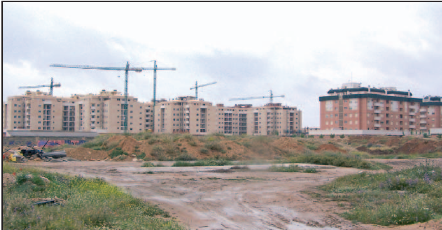
Paraje del sector 20 con las obras de otros sectores, prácticamente construidas, al fondo.
