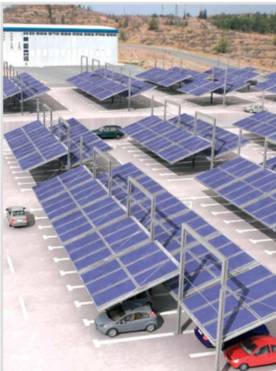
Imagen de un aparcamiento fotovoltaico.
