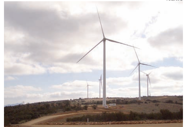
Parque eólico de Malagón, en Ciudad Real.
