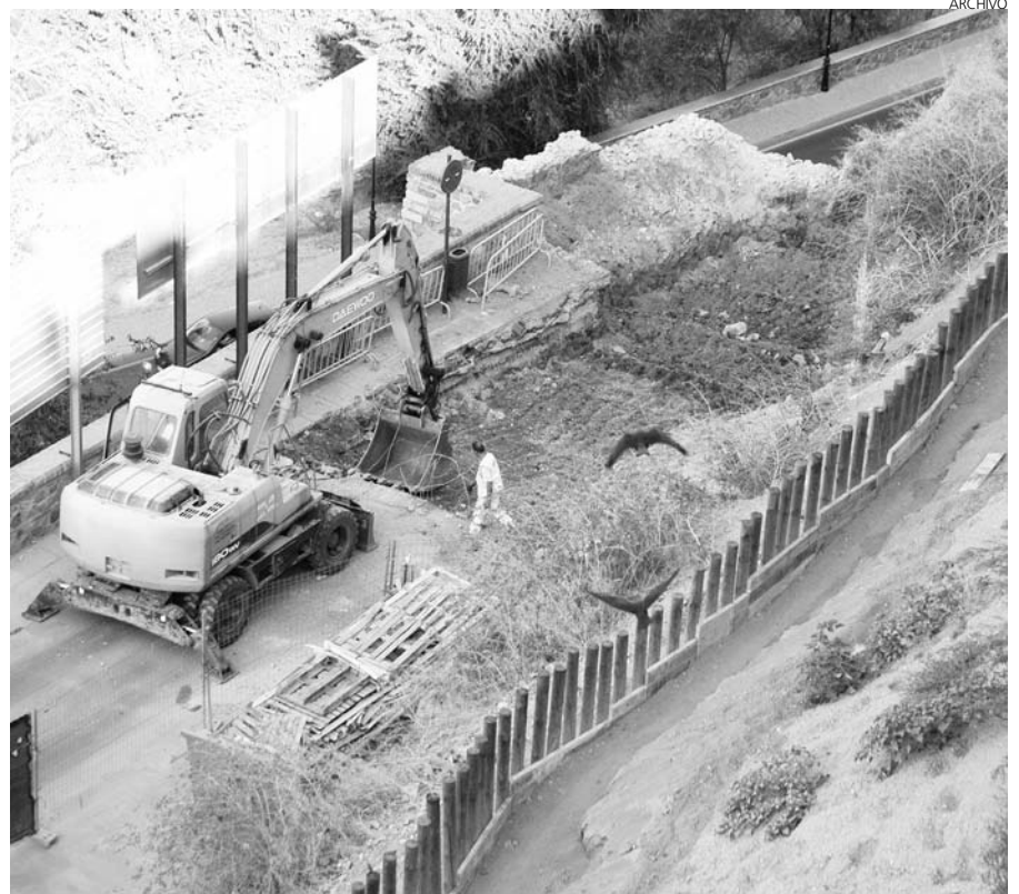
La obra pública en Castilla-La Mancha prácticamente está paralizada.
