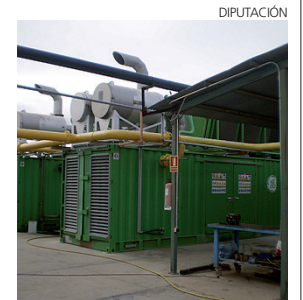
En la imagen, una planta de biodiésel.
