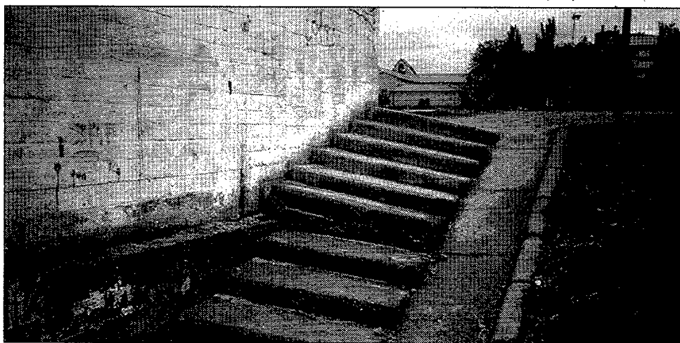
En el parque de La Rambla, junto al frontón, las escaleras están a punto de desmoronarse. GRUPO MUNICIPAL PSOE
