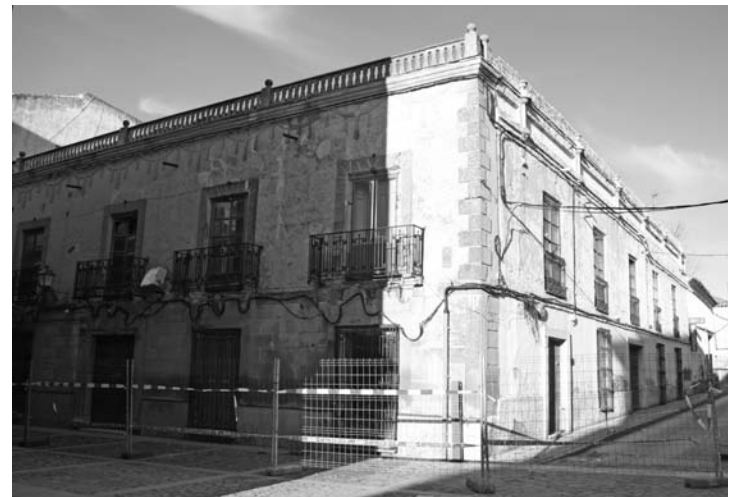
Estado del inmueble y perímetro de seguridad en c/ Mayor y Fuente
