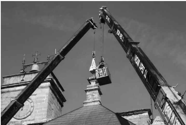
Instalación del nuevo pináculo en la cara sur de la iglesia de San Andrés
