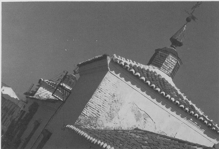
Vista de una de las torres del Palacio del Conde de Valdeparaiso, cedido recientemente a la Diputación Provincial para su restauración.
