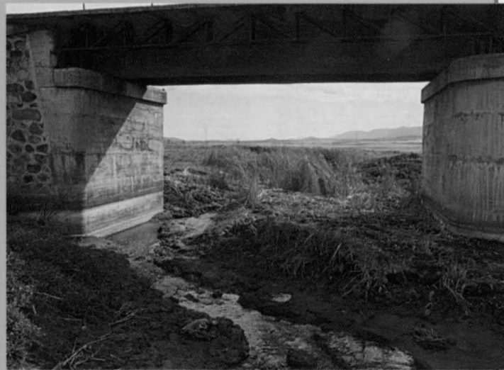
Tres vistas del Ojailén junto al puente de la carretera de Puertollano a Mestanza, donde puede apreciarse el deterioro actual del río.
