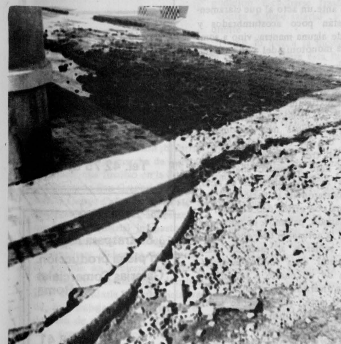
Daños causados por la rotura que se solventaron rápidamente
