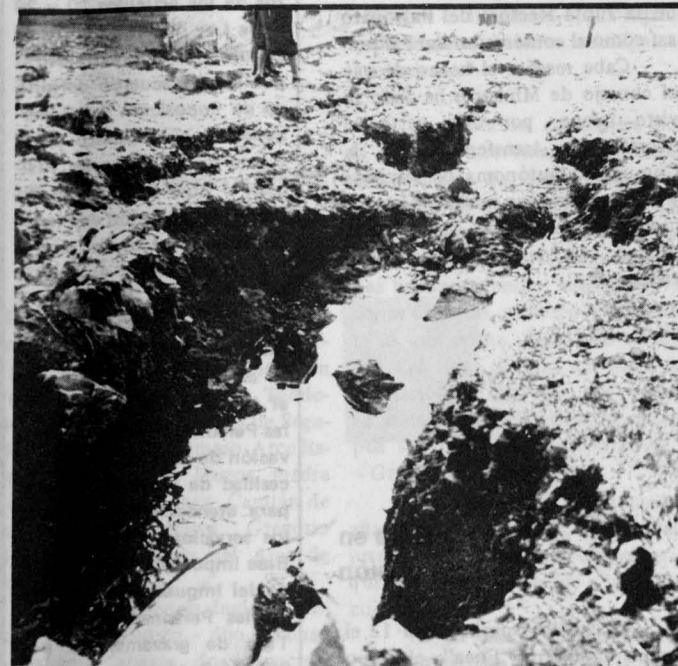
Estado de la tubería tras la rotura
