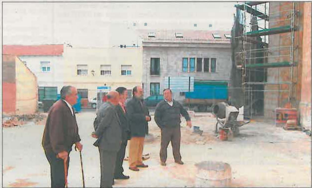
Momento de la visita a las obras de remodelación de la ermita del Cristo. (foto J.C.M.)
