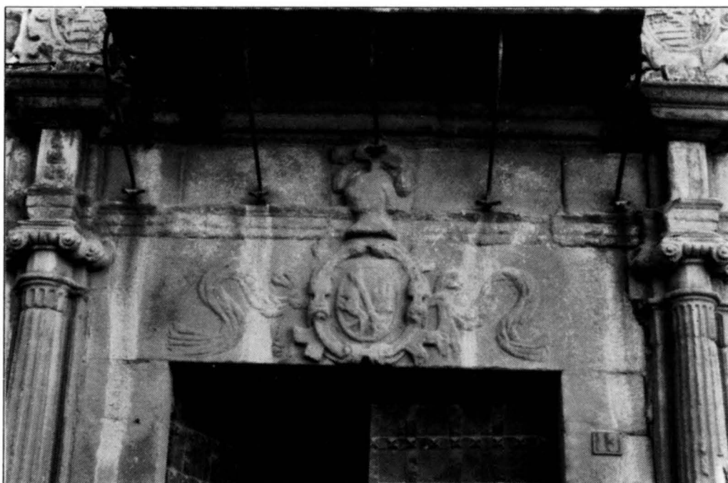
Pátinas de rubefacción provocadas por el forjado del balcón
