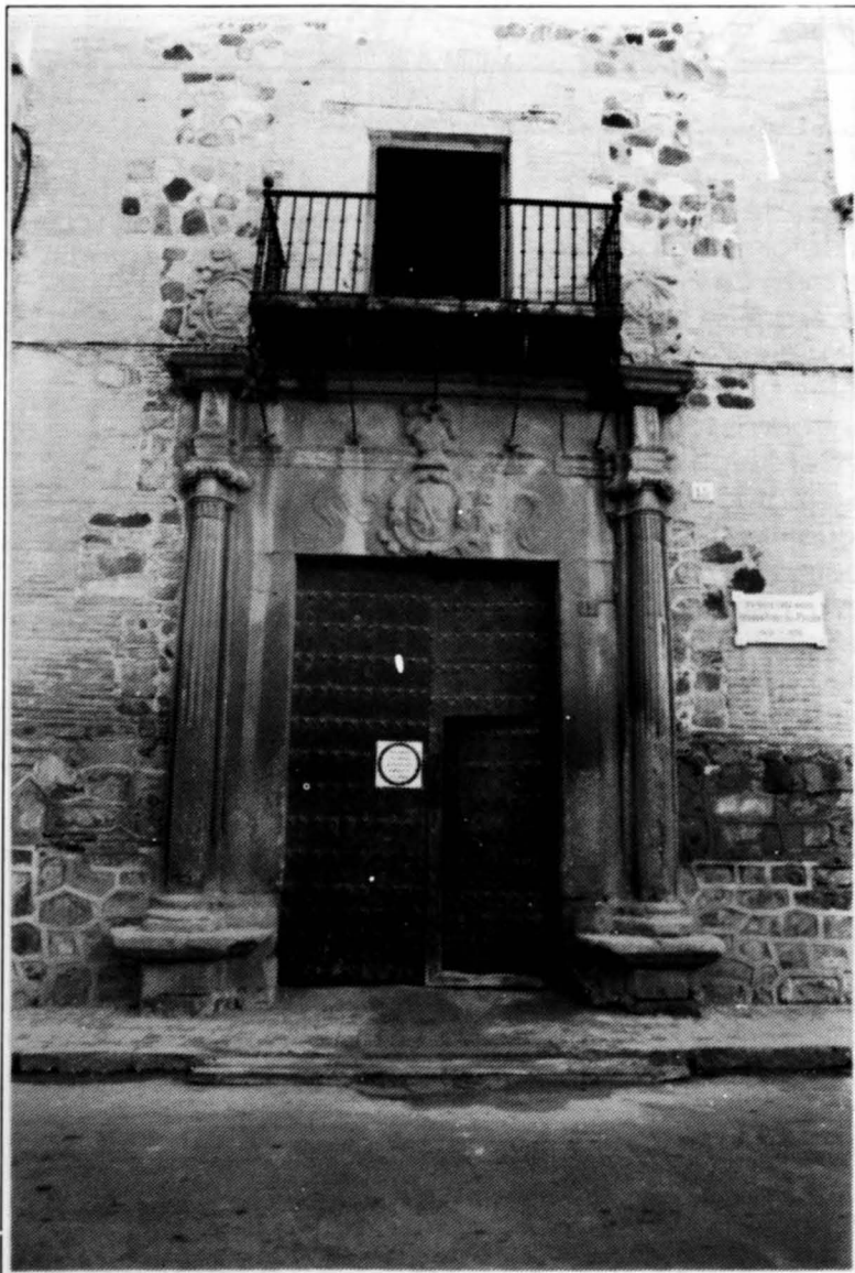
Fig.2 Portada de la Casa de Hernán Pérez del Pulgar. Obsérvese las manchas de humedad por ascensión capilar del agua desde el suelo.
