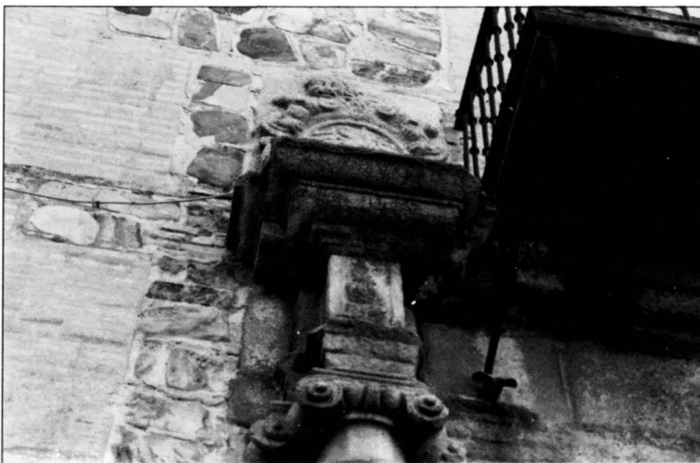
Pátinas verdosas provocadas por microorganismos.
