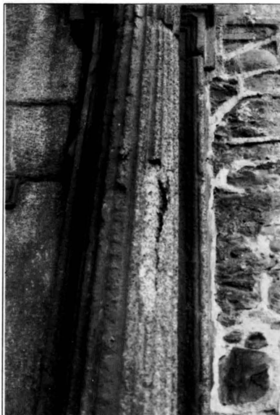
Disgregación granular en el centro de la columna derecha
