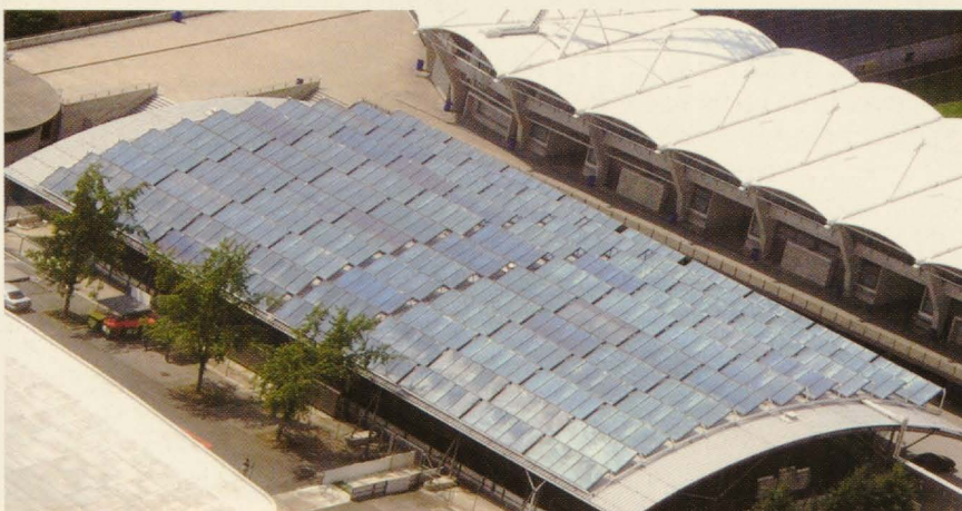
Captación de energía solar transformandola en energía eléctrica.
