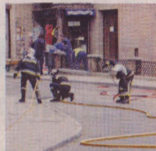
Los bomberos trabajan en la tubería de gas rota.
