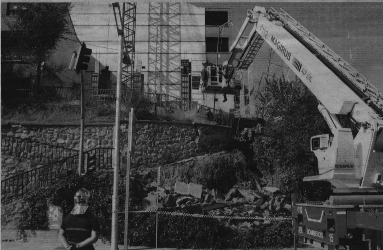
Los bomberos de Toledo derruyeron ayer, de manera controlada, el tramo del muro del paseo peatonal y de las escaleras situadas en la avenida de Madrid de la ciudad imperial, que el pasado fin de semana sufrieron daños importantes a consecuencia de las fuertes lluvias caídas en la capital regional. Así lo decidió la Concejalía de Gestión de los Servicios, movida por razones de seguridad. METRO
