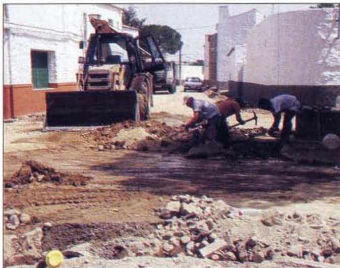
Las obras para cambiar la red de distribución de aguas en Villalba ocasionaron continuas roturas de tuberías.
