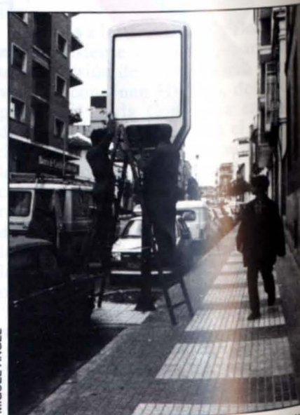
Varios operarios proceden a la puesta en marcha del nuevo reloj de la calle Seis de Junio.
