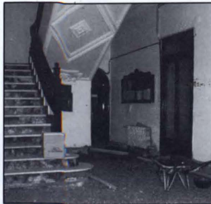
El hall de entrada al Ayuntamiento tendrá muy pronto un suelo nuevo.
