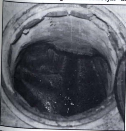
El escaso diámetro del colector es la causa de las inundaciones.
