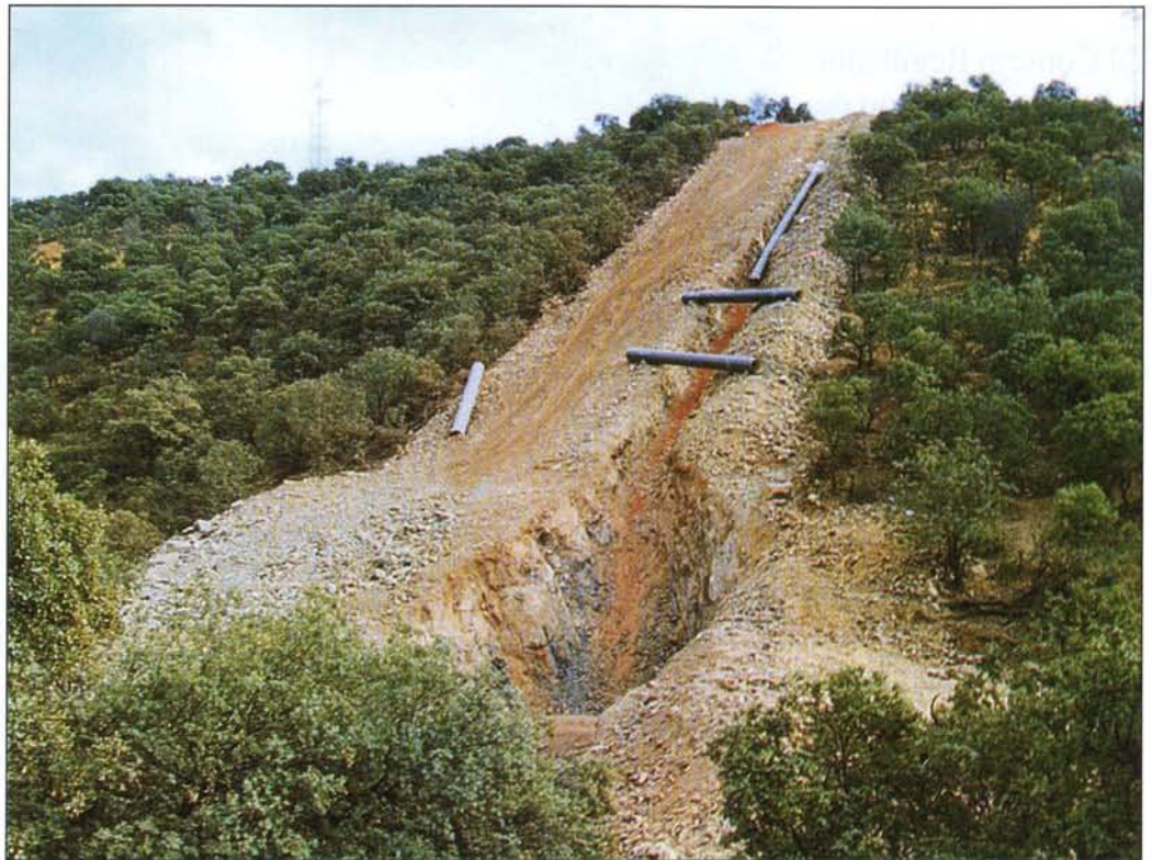
Ademont ha presentado una denuncia por delito ecológico y CEVA va a escribir a la Consejería para que subsane los daños ocasionados.
