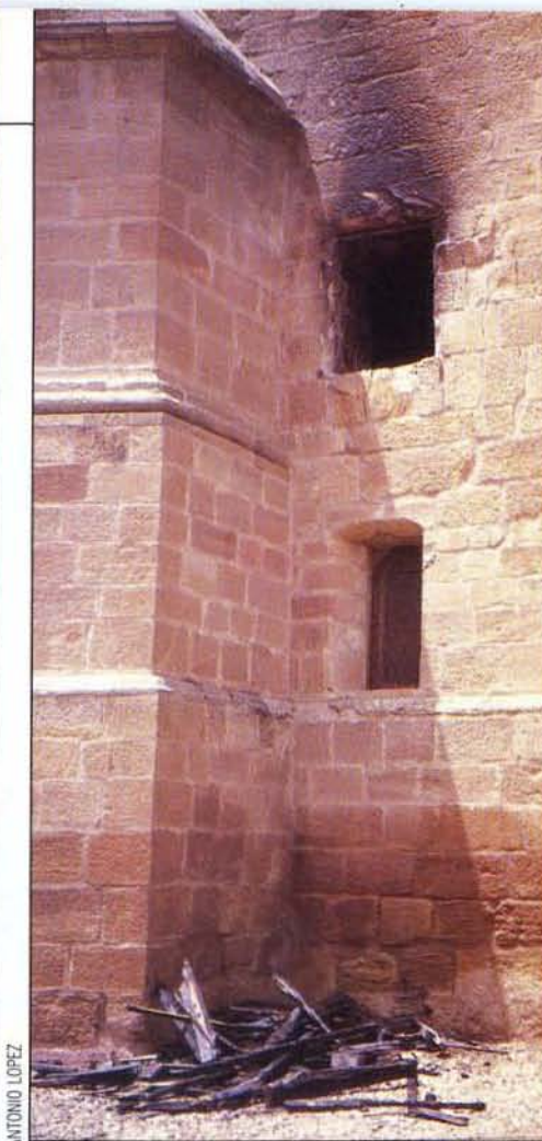
El incendio que siguió a la caída del rayo provocó graves daños en el camarín de la iglesia.
