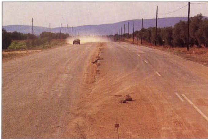
Más de cinco kilómetros están sin asfaltar
