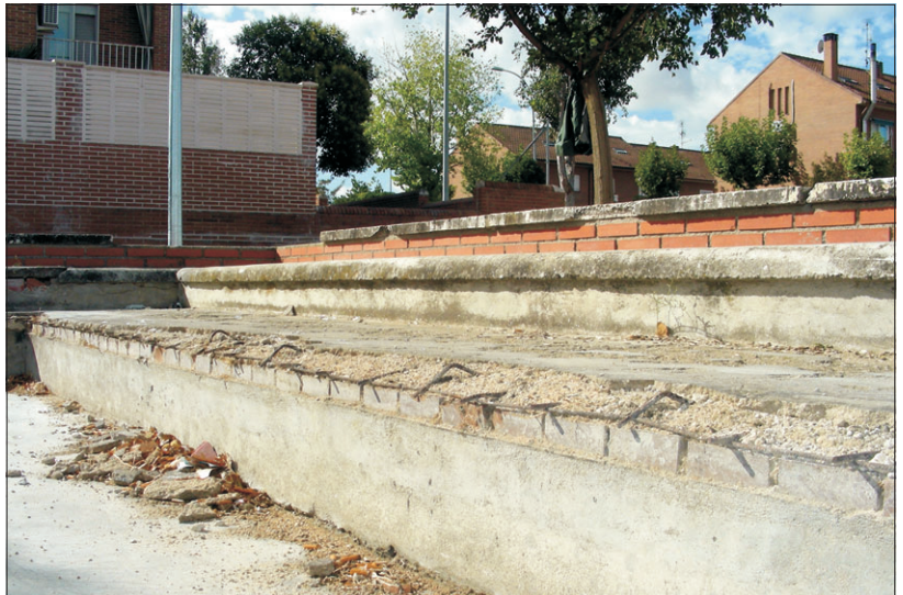
Por enésima vez hemos pedido que en las obras de Manuel Machado no dejen esto pues tiene mucho peligro.
