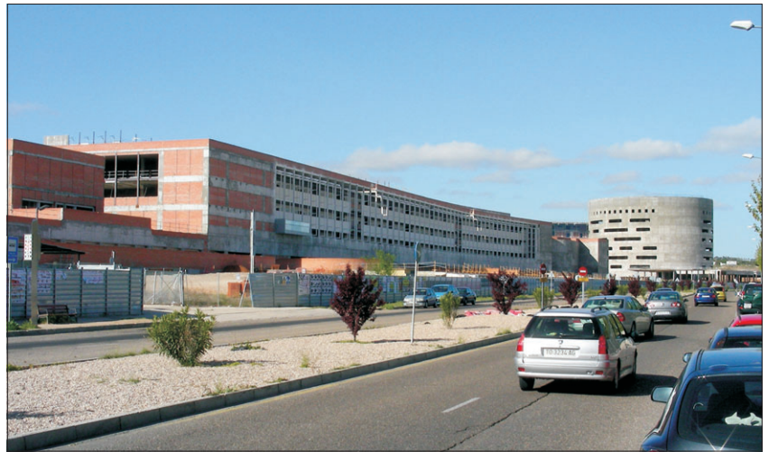
Estado de abandono de las obras del nuevo hospital.
