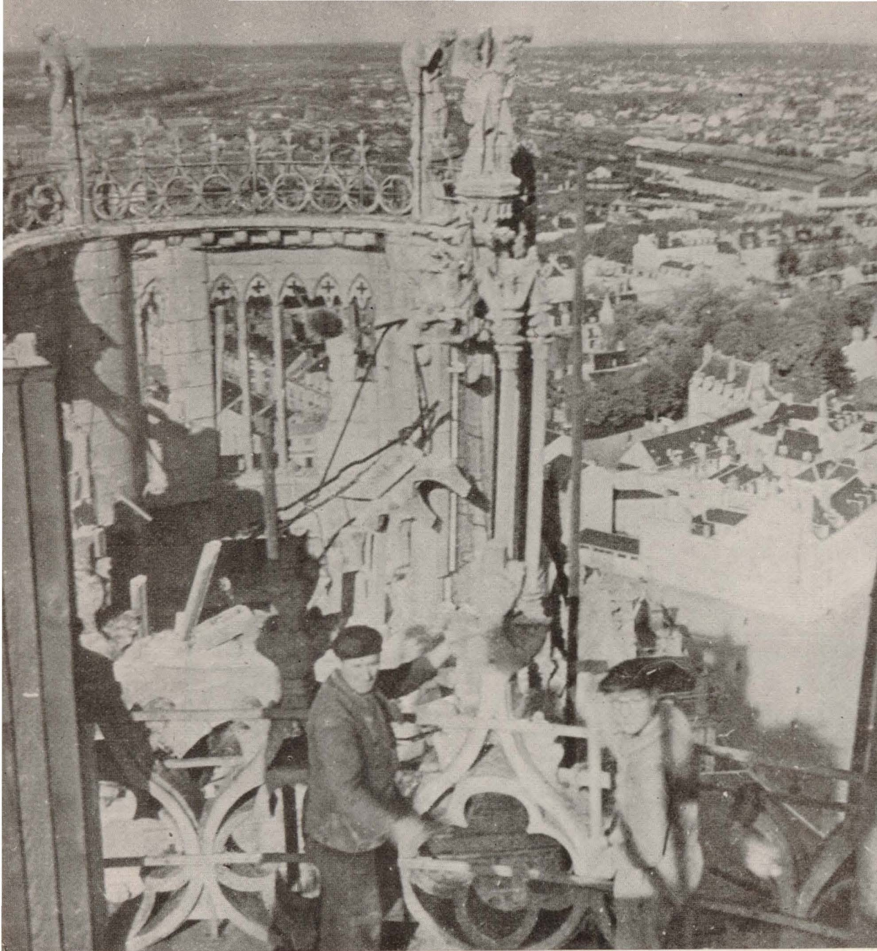
Orléans.—Una torre de la Catedral, destruida. Abajo: Restauración de una torre mutilada por los bombardeos.
