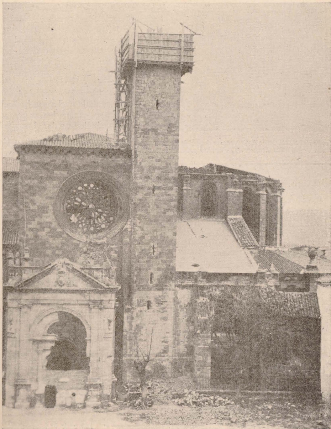
Torre del Santísimo, desde la plaza del Mercado, preparada para las obras.
