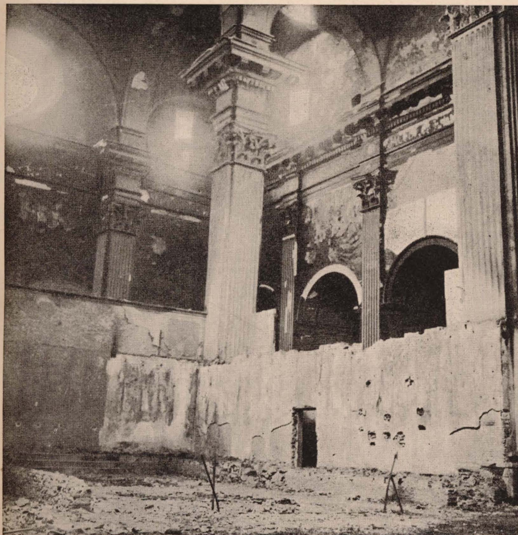
Recinto que ocupó la sillería del Coro. Paramento en el cual se hallaba construido el órgano. Fotografía obtenida en enero de 1937. Se aprecia el efecto de las llamas en la pared circundante.
