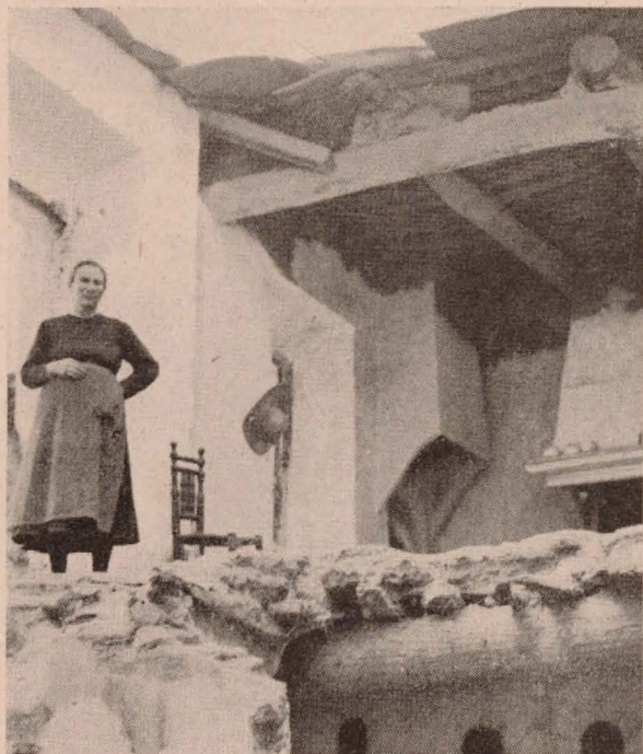
Pitres: Estado en que quedaron las viviendas.
