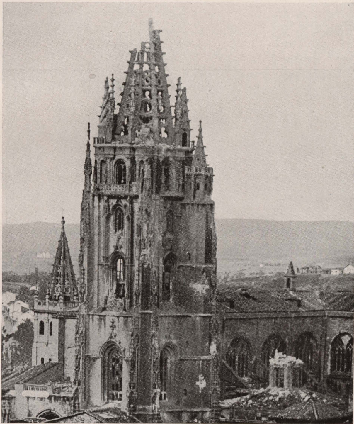
OVIEDO.—Catedral. Conjunto exterior de la torre antes de la instalación del andamio.
