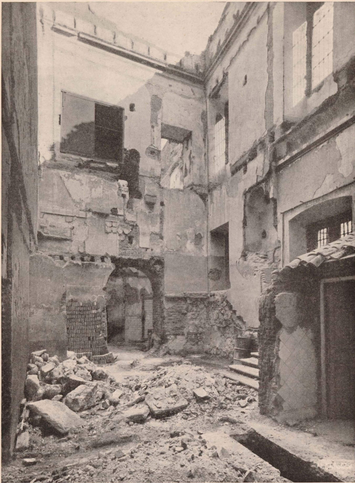
Patio interior, después del incendio.
