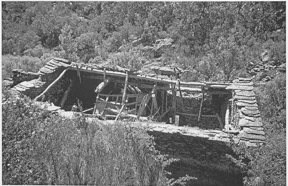
Foto 6 LA HUERCE. MOLINO DE LA HUERCE Cubierta a dos aguas prácticamente caída.
