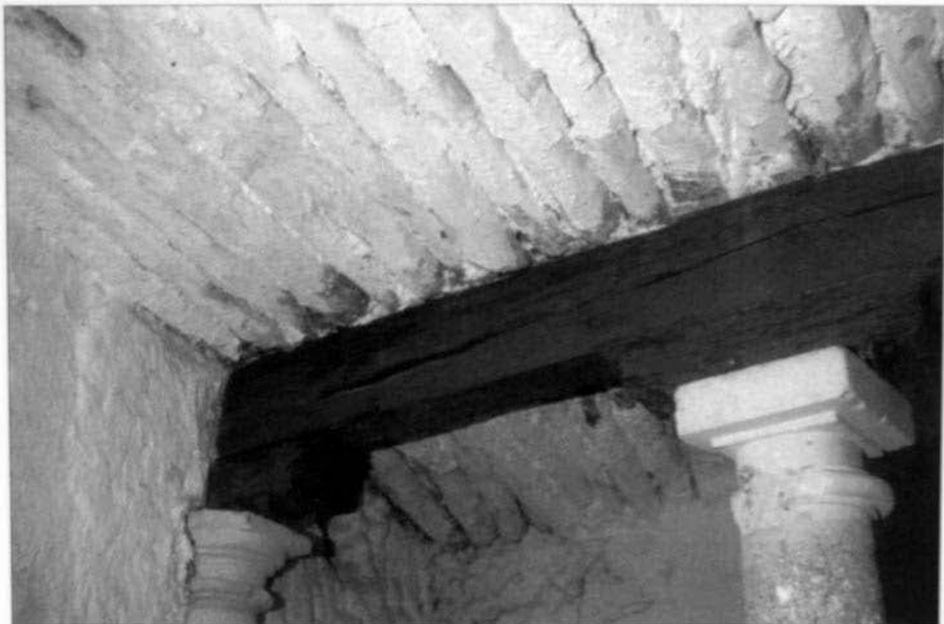
Letur. La madera utilizada en construcciones antiguas sirve para extrapolar los árboles disponibles y su calidad en aquella zona.
