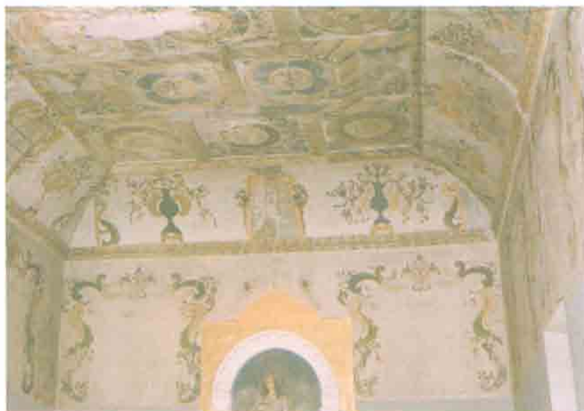
Fot. 6.- Ermita de San Roque. Tarazona de la Mancha. Pinturas de la zona del altar. En la hornacina figura la imagen de Santa Lucía. (Fot. J. Sánchez Ferrer).
