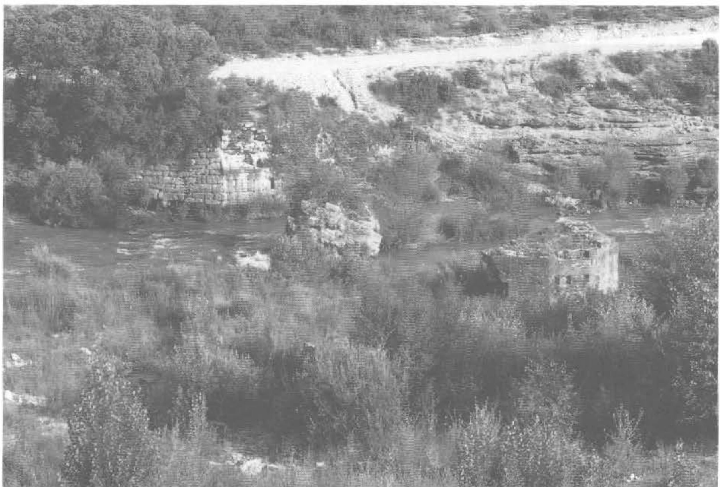
Lámina IV - a) Pilar semicircular aguas abajo y restos de calzada. b) Pilar con tajamar y espolón triangulares, semejante al del puente de Villar de Olalla (Cuenca). Oquedades para la cimbra.
