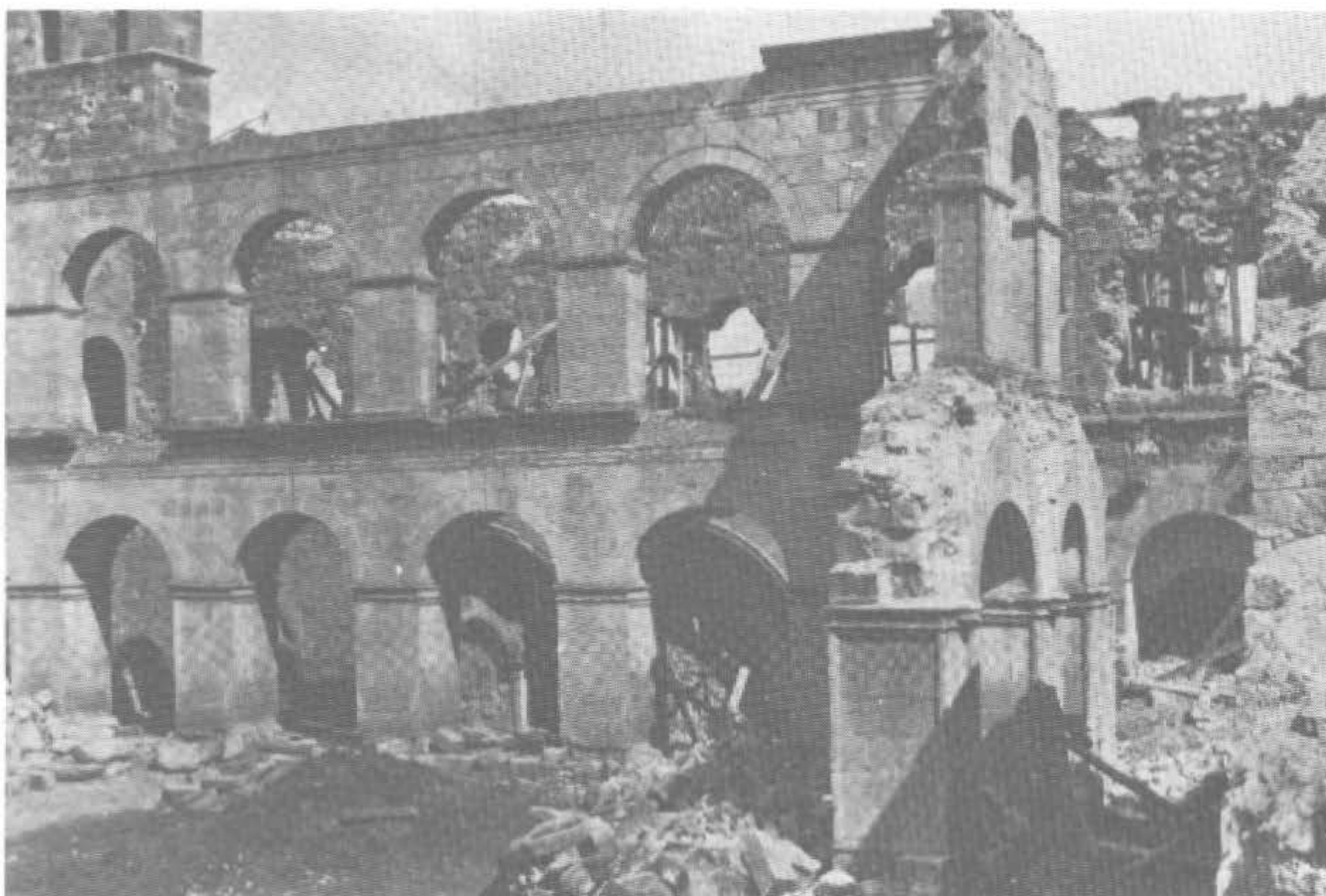
15a.—Monasterio de Ovila (Guadalajara), 1931. Aspectos del claustro al inicio de los trabajos de demolición. Foto A. Byne. Cortesía de De Young Museum. A través de las arquerías se puede ver el frente de la Sala Capitular y a la derecha la puerta de ingreso al Locutorio. Arquitrabe y friso del orden superior se encontraban intactos.
