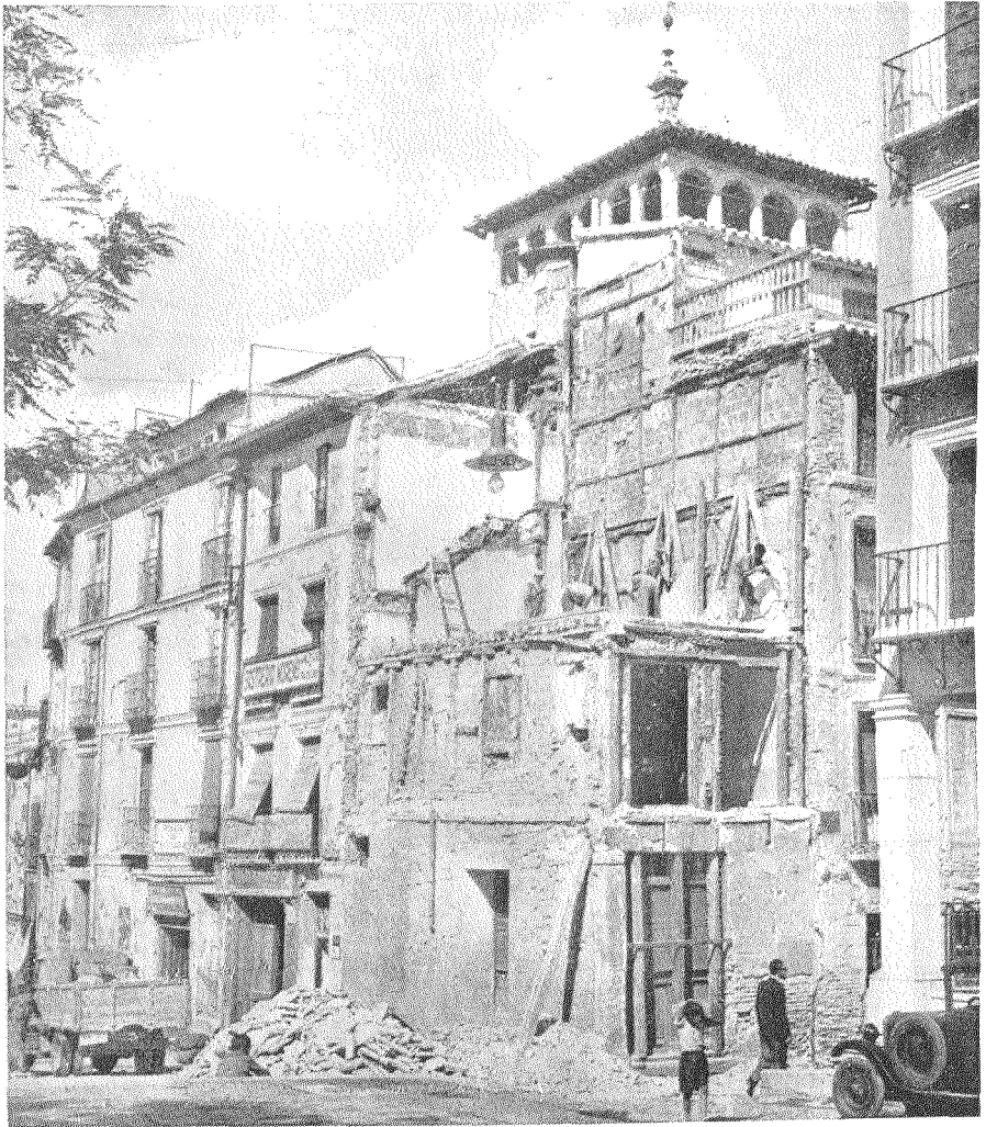
Derribo de la casa que forma la esquina del añadido de la calle de las Armas, con la que se alineó la nueva fachada.
