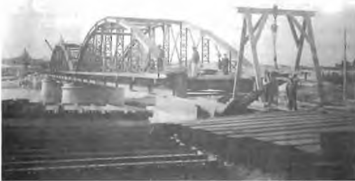
Foto 6.- Montaje de piezas metálicas, hacia 1907. (Foto Ruiz de Luna. Colección Consejería de O. P.).
