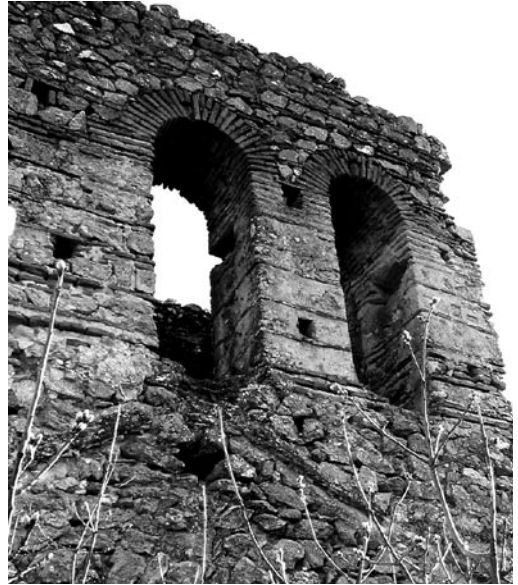
Fig. 4. Detalle de la fachada norte de la torre con restos del tejado de la iglesia (Imagen: D.G.P.)
