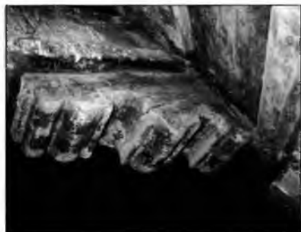
Fig. 54: Can de lóbulos en la armadura de limas en el Lado a (crujía norte) del piso superior.
