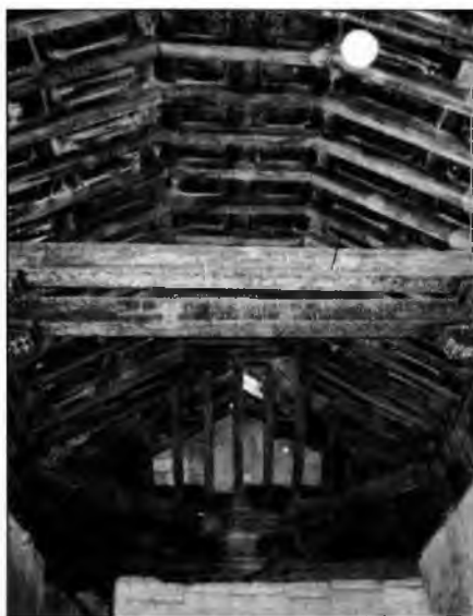
Fig. 52: Armadura de limas en el Lado a (crujía norte) del piso superior.
