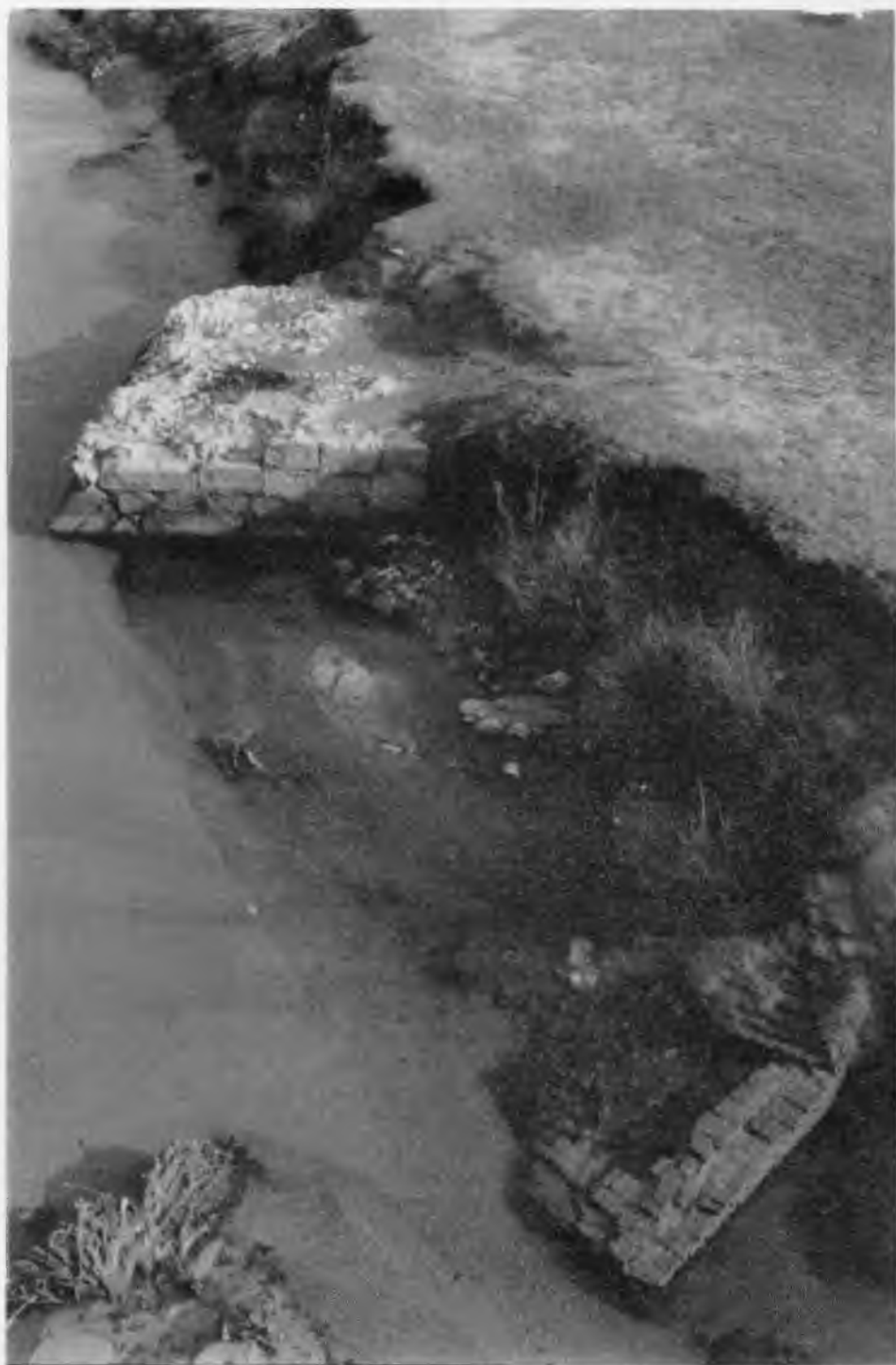
Escalona (Toledo), Puente sobre el río Alberche. v. 1992. ¿Restos de una construcción anterior?
