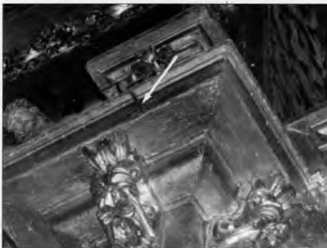
Anclaje para paños de Cuaresma y Semana Santa. Se aprecian leves desencajes causados por el terremoto de 1755.
