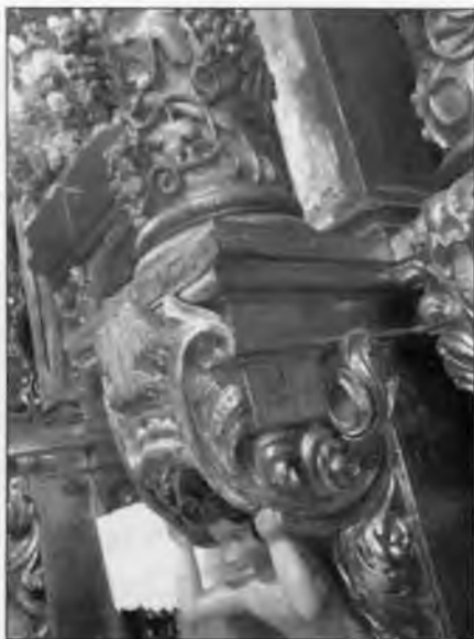
Daños en ménsula y basa.
