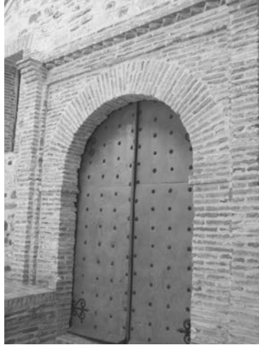
15. Portada occidental de la ermita de Nuestra Señora de las Virtudes, Santa Cruz de Mudela.
