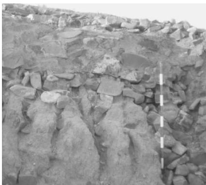
Figura 2: Degradación de los muros provocada por la lluvia y escorrentías. Foto GICC.
