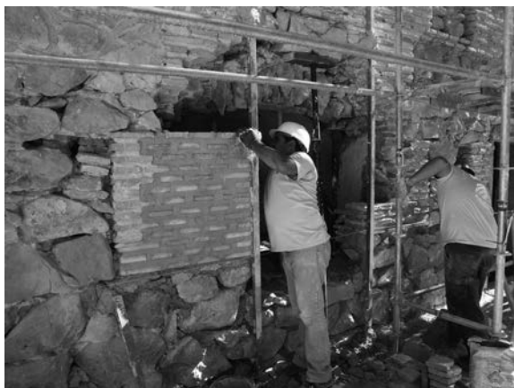
18. Trabajos de recomposición de la geometría original de las ventanas de la planta baja de la fachada norte de la Cámara.
