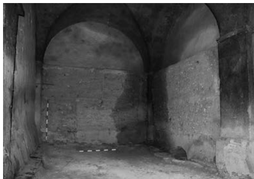
15 A. El interior de la planta baja de la Cámara, antes y después de la eliminación de las compartimentaciones de mediados del siglo XX.
