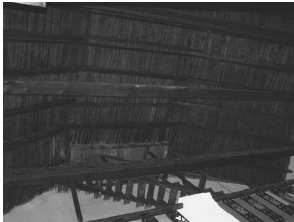
12. Detalle de la armadura de la iglesia de la Inmaculada Concepción, Cañada de Calatrava.
