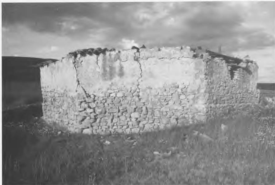
Lám. IV: Estado Actual del edificio de la noria de la salina "La Abundante" de Bujalcayado, como puede observarse el deterioro de la misma es notable.
