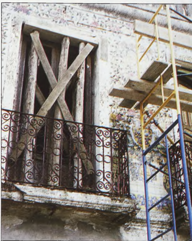
El deterioro que sufre el bar El Pilar, cuya fachada está revestida con cerámica de gran valor, es un claro ejemplo del mal estado del patrimonio talaverano
